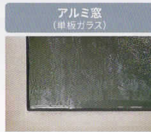
ガラス・フレームに結露発生
